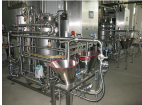
Bild Betrieb: Fruchtdosieranlage
